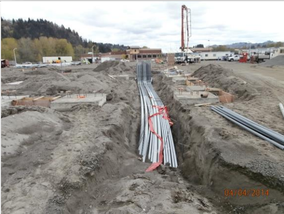
Underground electrical conduits
